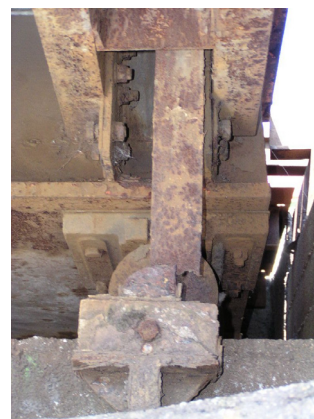
Obr. 4 Prasklé ztužující svislé táhlo na opěře č.1
