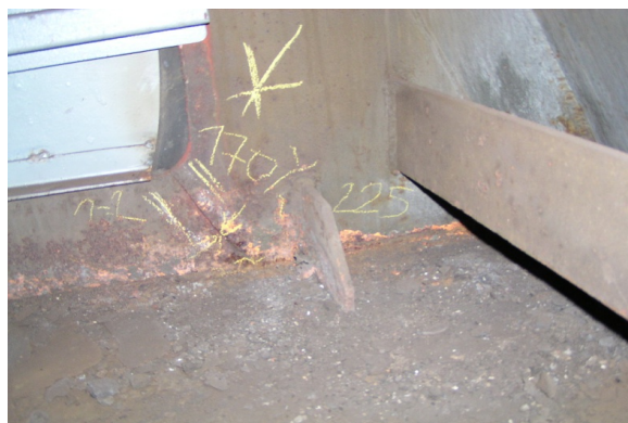
Obr. 5 Trhliny v čele komorového nosníku
