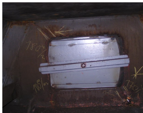
Obr. 6 Trhliny v čele komorového nosníku
