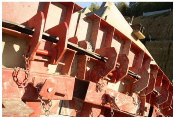
Obr. 6 Detail čela s vloženým těsnícím pásem pro utěsnění spáry mezi bloky betonáže
