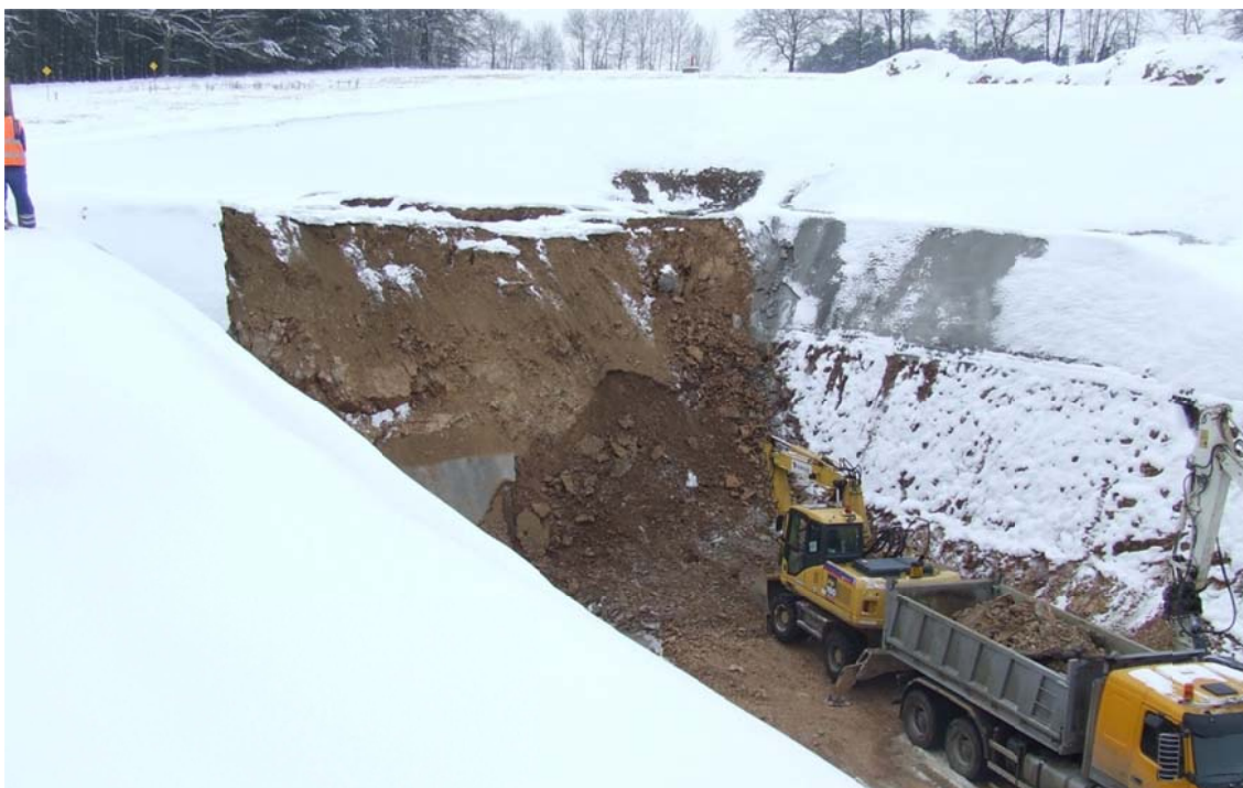
Obr. 2 Sesuv čelní portálové stěny
