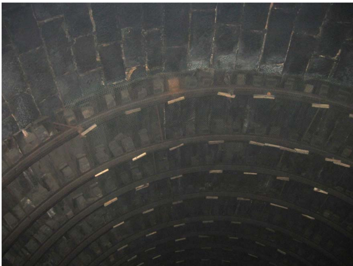
Obr. 1 Stav tunelu před sanací – podsružení
