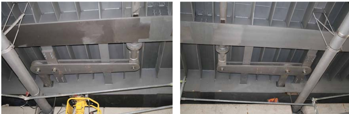
Obr. 4 Řídicí tyč na mostu v Drážďanech, detail u opěr
