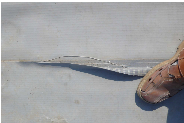
Obr. č. 5 – Delaminace syntetické fólie PVC
