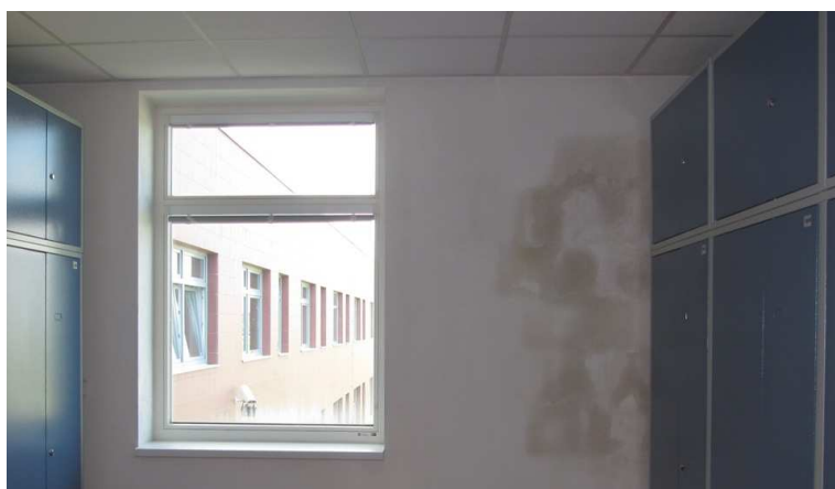
Obr. č. 2 – Výluhy na fasádě
