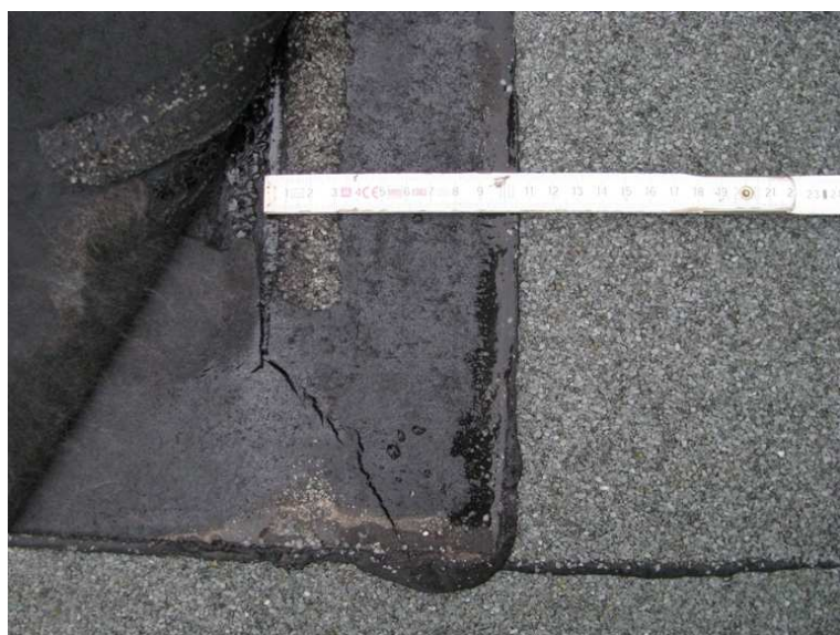
Obr. č. 6 – Delaminace asfaltových modifikovaných pasů
