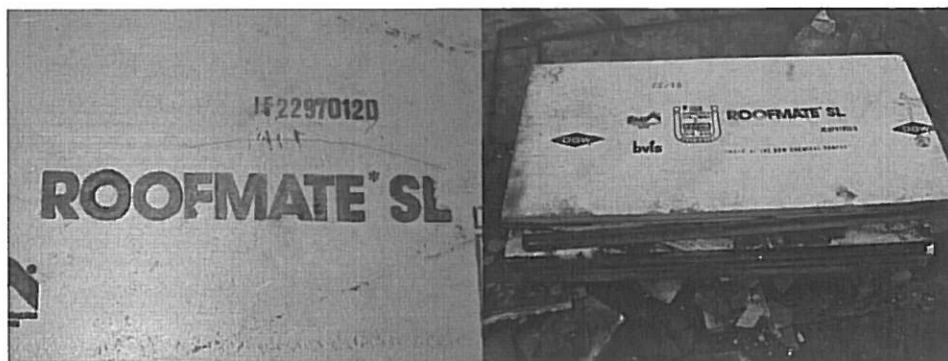
Obrázek č.4 - Stav desek Roofmate SL
